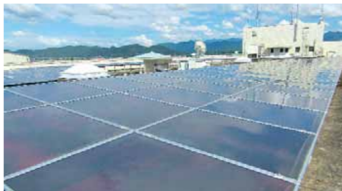
▲太陽光発電設備(役場本庁舎)
